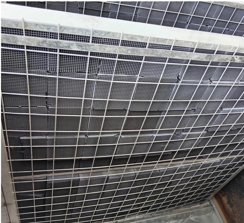
图 3-3 活性炭处理设施现状图
