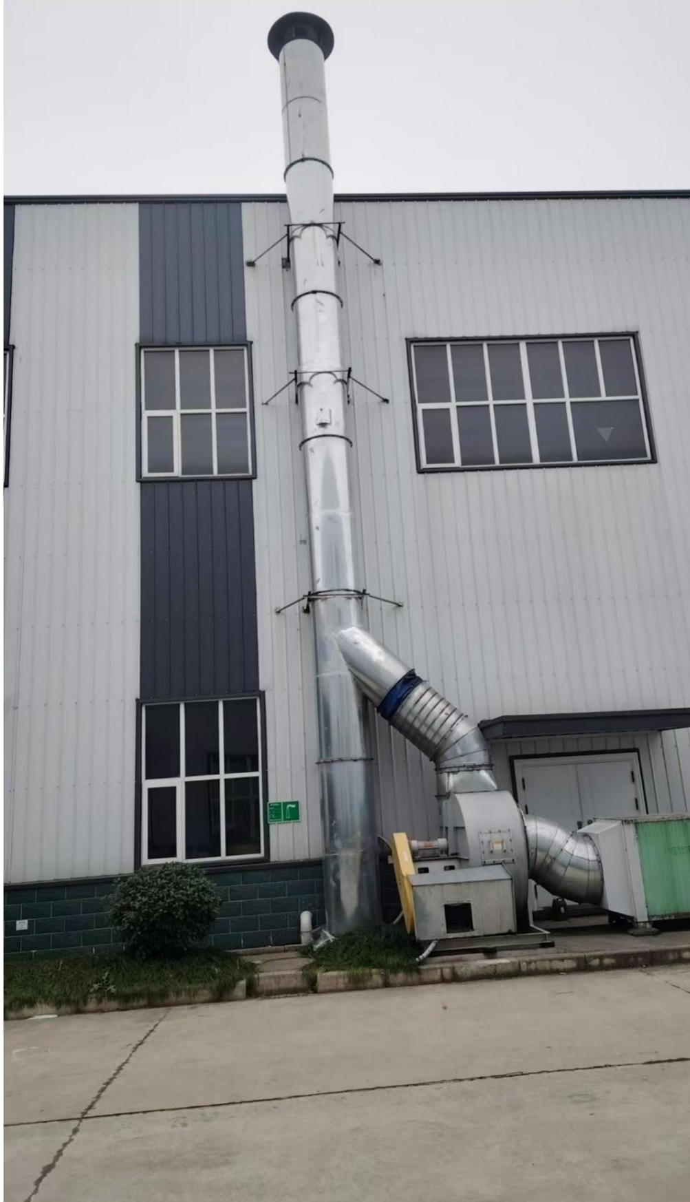
图 3-4 废气处理设施及烟囱现状图
