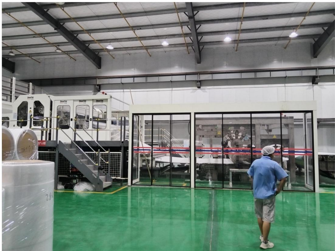
图 3-4 生产线纤维尘废气收集装置
