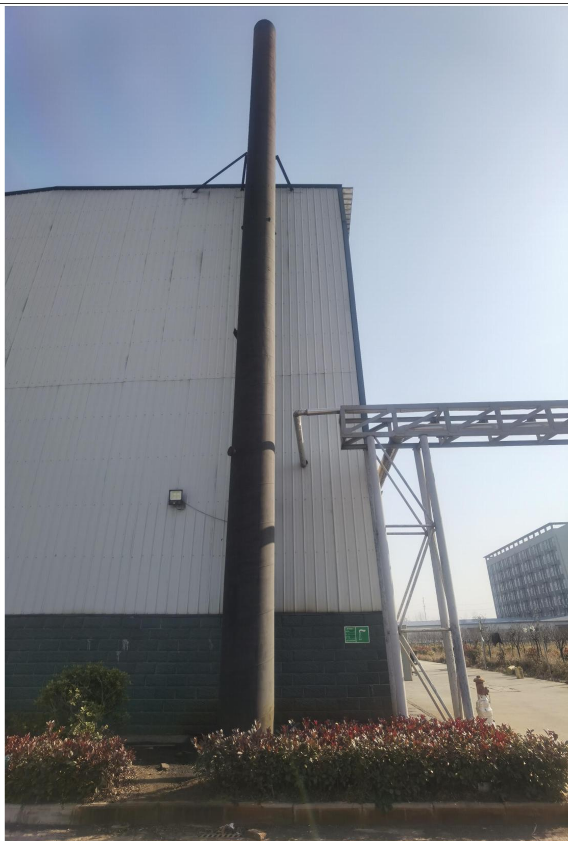
图 3-3 生物质锅炉房排气筒设施现状图
